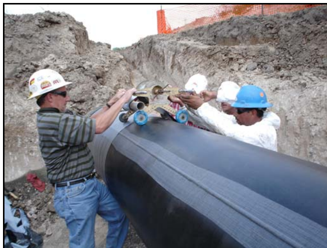
L'utilisation d'une machine pour la pose du revêtement permet d'obtenir une tension bien plus élevée. La résistance du revêtement à la tension du sol sera ainsi renforcée.
